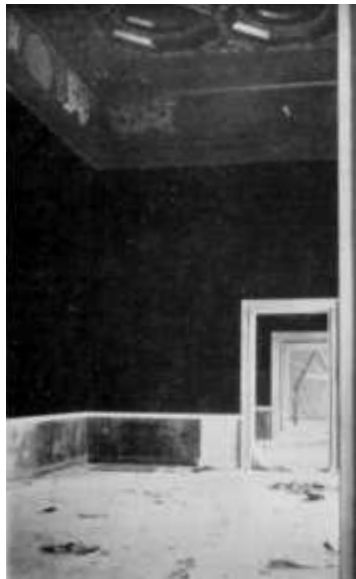
Ferrara marzo 1933, lavori nelle sale destinate ad ospitare il settore cinquecentesco della Esposizione.
